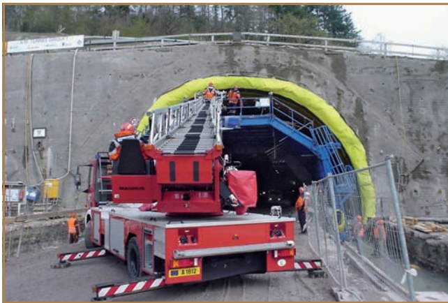
FOTO: Bergungsaktionen wie kürzlich dieser Arbeitsunfall auf der Tunnelbaustelle „Grouft“, bei dem ein Arbeiter mit Rückenverletzungen von einem Baugerüst geborgen werden musste, verlangen eine präzise Teamarbeit
